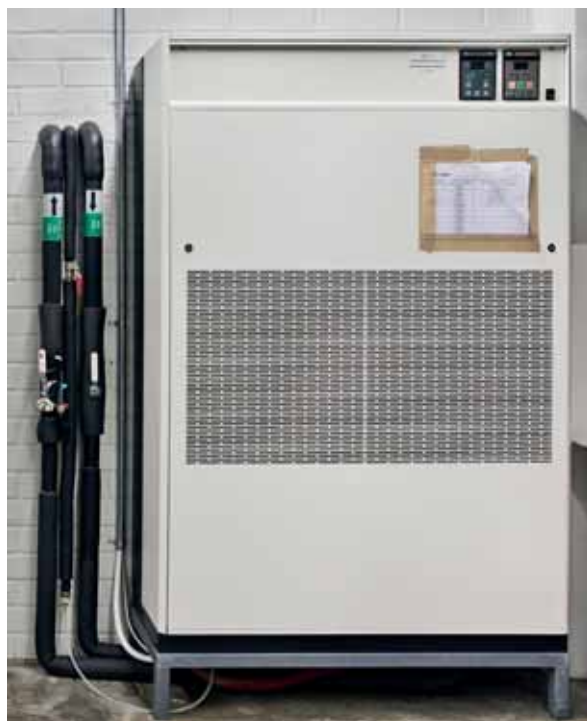
Vakioilmastointikone, jonka tehtävänä on säädellä ja kontrolloida säilytystilan lämpötilaa ja ilmankosteutta.
